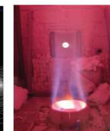
超低NOx燃烧器火焰 Ultralow NOx burner flame
