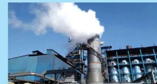
唐山天茂实业冲渣乏汽除湿脱白项目 Tangshan Tianmao project
