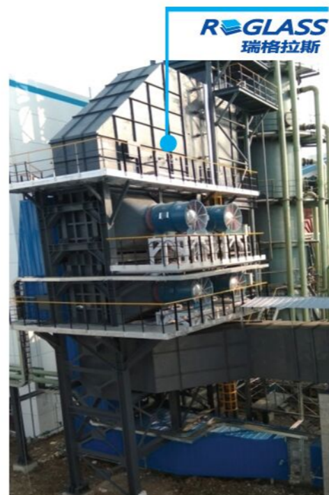
江苏通达热电脱硫湿烟气除湿脱白项目
